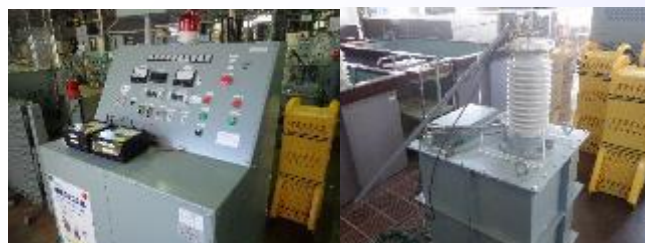
誘導耐電圧試験装置
