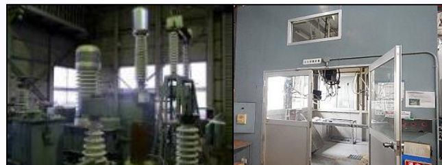
注水耐圧試験装置
